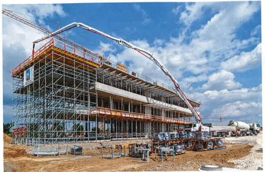
Mit der Skydeck Bühne am Deckenrand und den integrierten Arbeitsebenen beim Peri Up Traggerüst konnte ein hohes Sicherheitsniveau mit raschen Montagefolgen erreicht werden.
